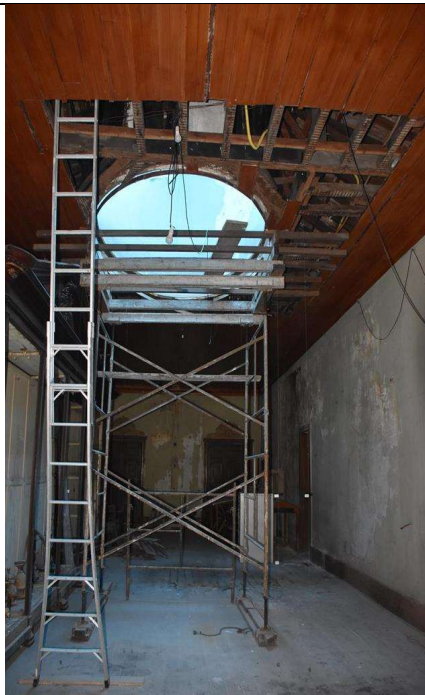
Lanternim que se encontra em avançado estado de degradação das suas estruturas. Um escoramento com peças de andaime
