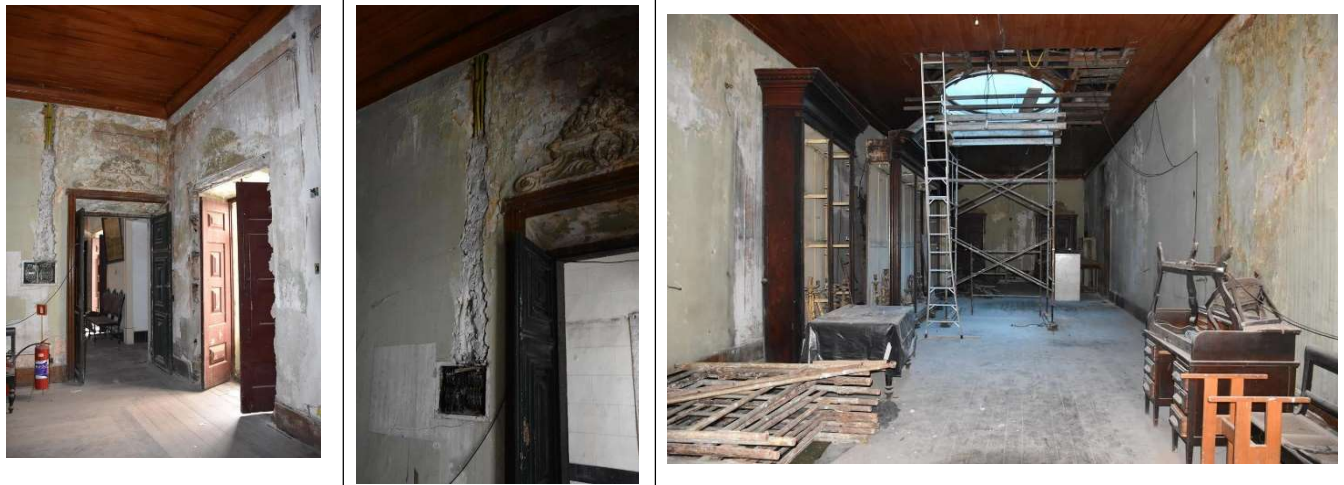
Pavimento superior. Infiltração, degradação das alvenarias, instalações elétricas fora da norma técnica, grosseiramente executada, com evidente risco à integridade e segurança da edificação Foto: (03/24)
