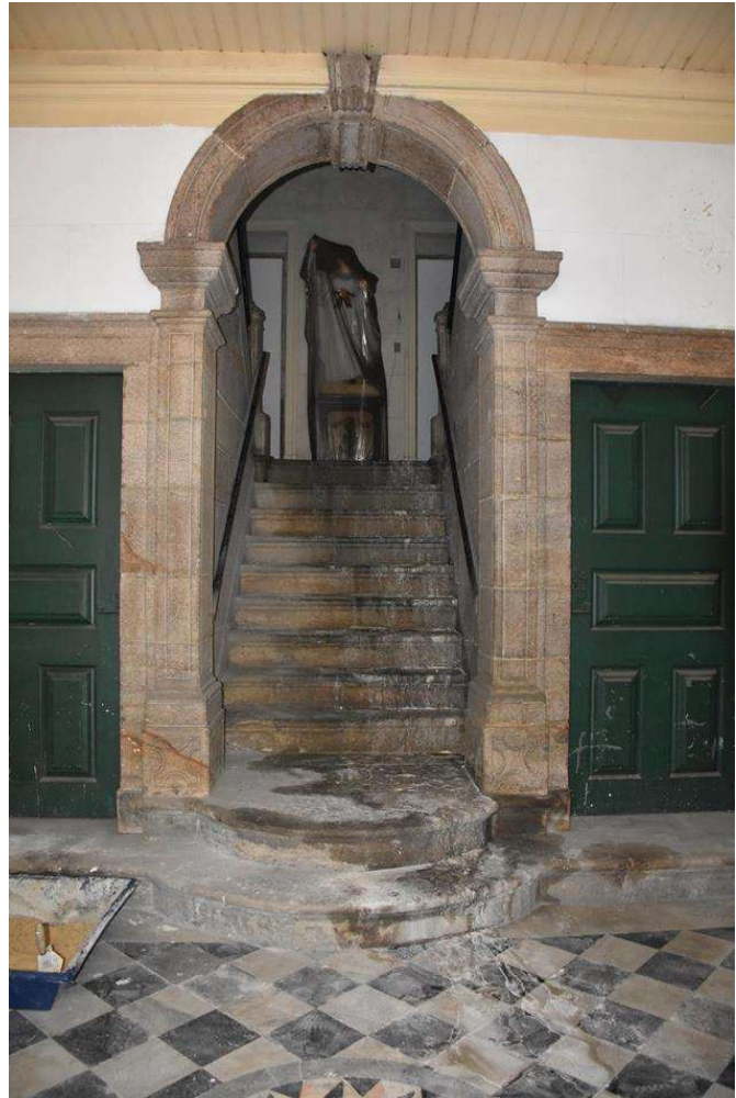
Hall de acesso ao pavimento superior onde podemos observar o encharcamento dos degraus pela agua da chuva, em uma sequência de degradações, das estruturas a partir do telhado, do forro em estuque e das alvenarias da caixa da escada. Foto: (João Leal-10/22)
