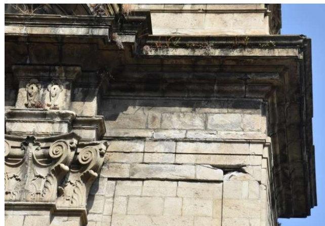
Vistas de detalhes da fachada principal apresentando diversas patologias de degradação dos seus elementos. Foto: (30-abril-2024)
