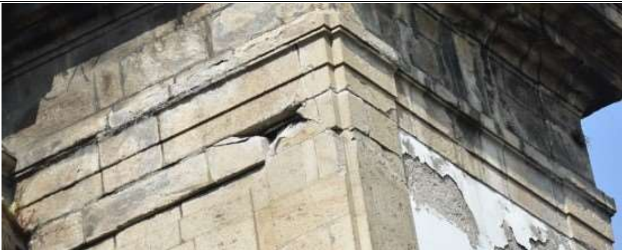
Vista de detalhe da fachada principal, com avançado grau de degradação dos elementos pétreos onde já ocorreram desprendimentos de trechos da cantaria, e do revestimento. Foto: (30-abril-2024)
