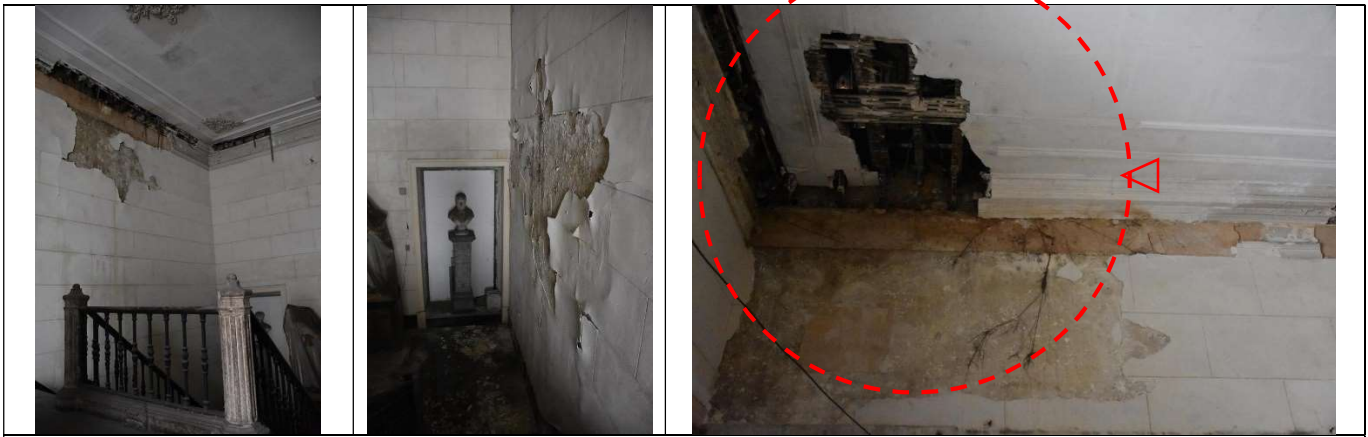
Caixa da escada de acesso ao pavimento superior. Observar a degradação da alvenaria e a presença de raízes em desenvolvimento avançado entre o reboco e o emboço. Desprendimento e ruptura do forro de estuque onde fica visível a deterioração das estruturas de sustentação do telhado. Foto: (-03/24)
